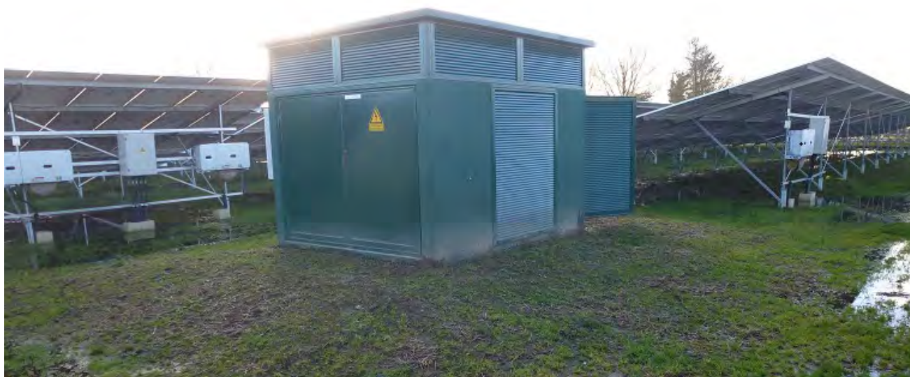
Figur 5-8 Eksempel på en af de små transformerstationer (fra et andet projekt).
