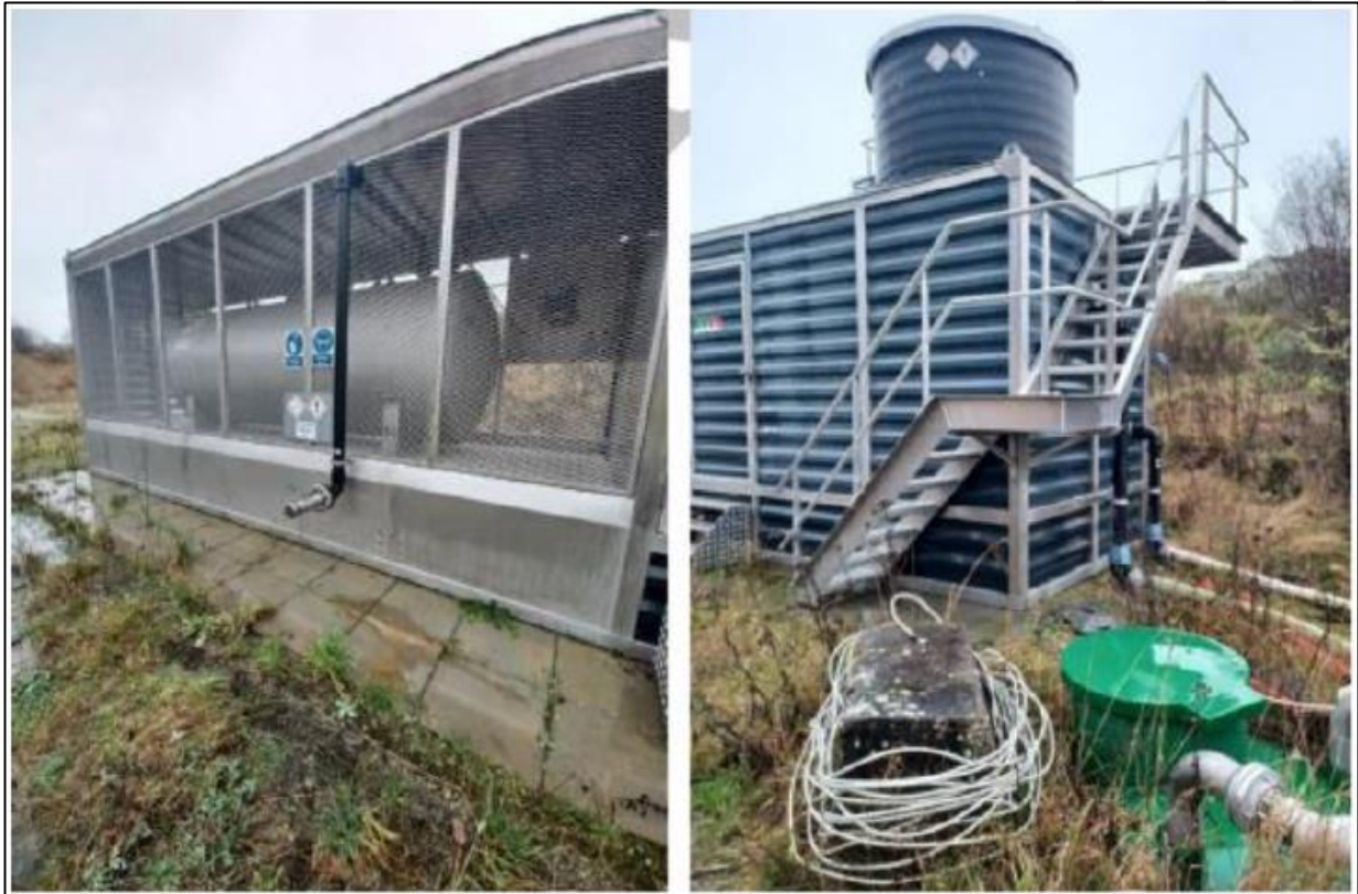
Udseende af perkolatforbehandlingstanken.
